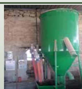
IMPIANTO ESTRAZIONE SILOS DOSAGGIO E MISCELAZIONE
