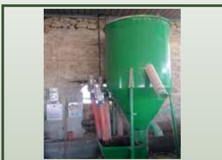
IMPIANTO ESTRAZIONE SILOS DOSAGGIO E MISCELAZIONE
